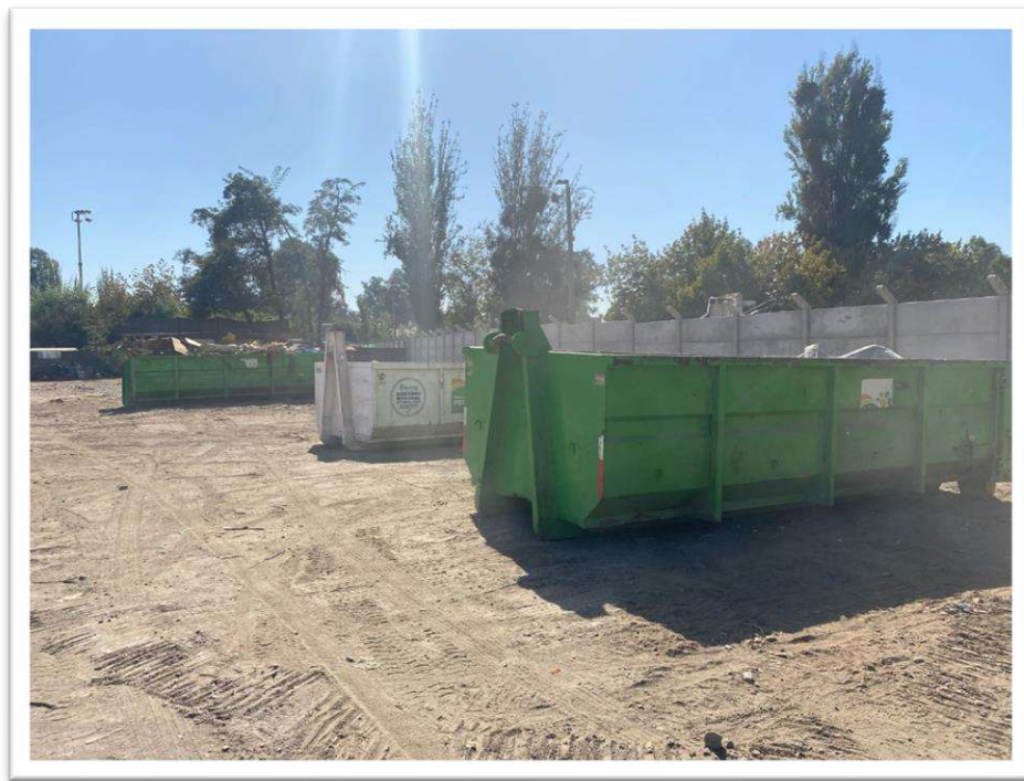
Imagen N°1 - Patio De Recepción De Fondos De Patio
