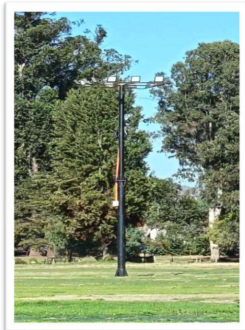
Nueva torre de iluminación en la explanada
